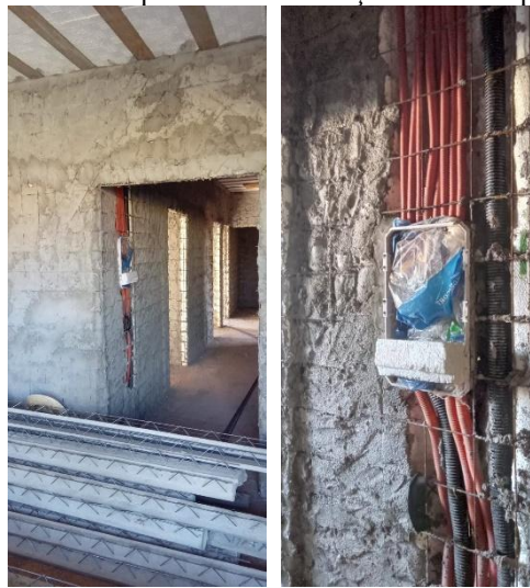
Figura 25 – Detalhe do quadro de distribuição fixado no painel em EPS
