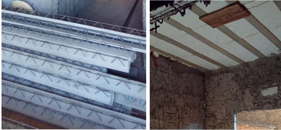
Figura 29 – Trilhos de laje treliçada (à esq.) e finalização da laje de um cômodo (à dir.)
