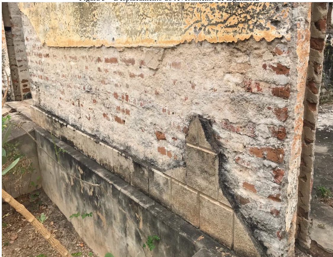
Figura 5 – Deslocamento do revestimento de argamassa
