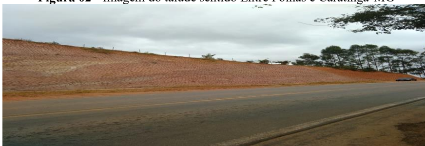
Figura 02 - Imagem do talude sentido Entre Folhas e Caratinga-MG
