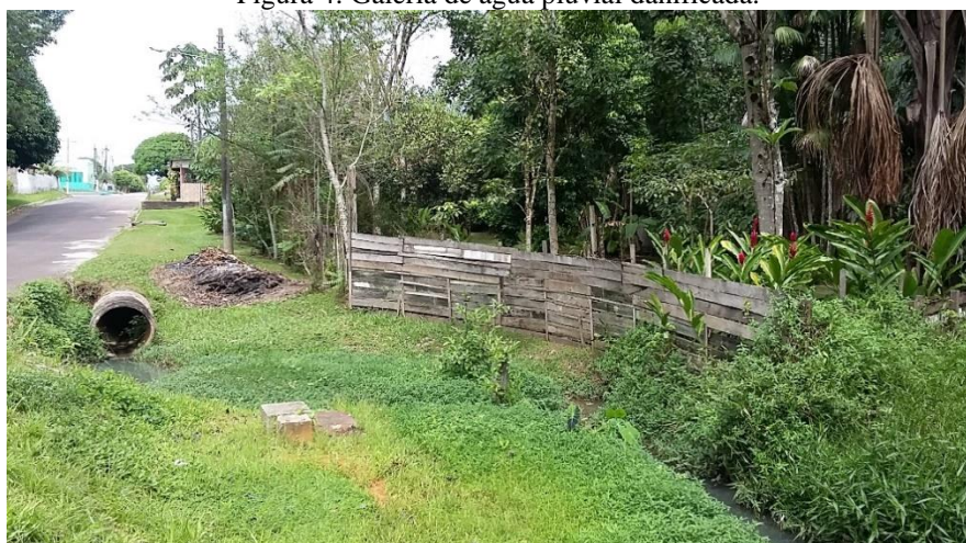
Figura 4: Galeria de água pluvial danificada.
