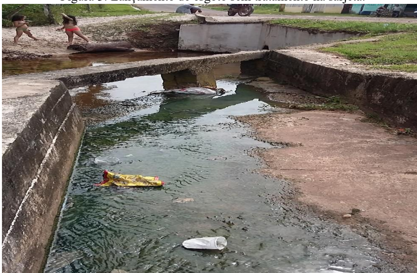
Figura 3: Lançamento de esgoto sem tratamento na sarjeta.
