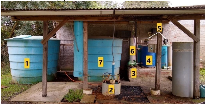
Figura 1: Equipamento de tratamento utilizado nos ensaios.
