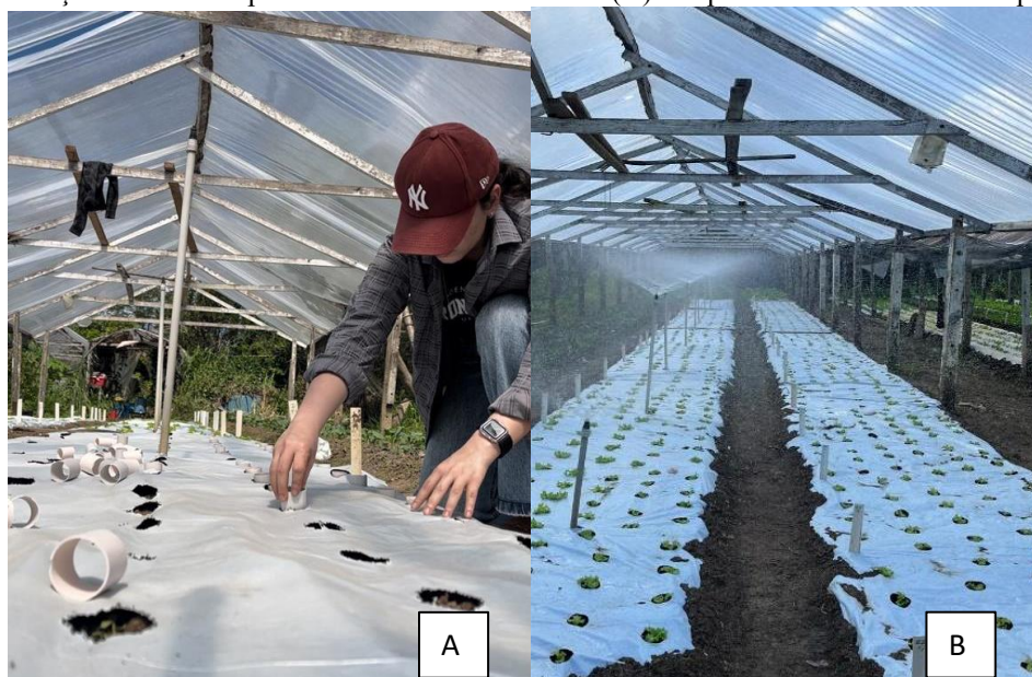
Figura 2- Pedacos de canos de pvc sendo colocados nas lonas (A) e experimento inteiramente implantado (B)
