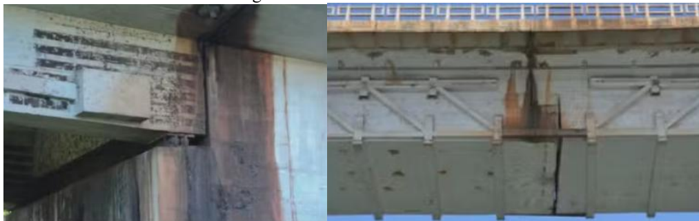
Figura 4. Fissura no vão central.
