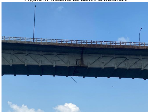
Figura 3. Detalhe de danos estruturais.
