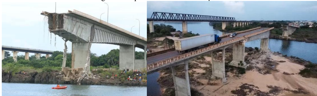
Figura 5. Ruptura do vão central da ponte.
