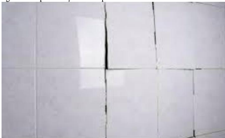
Figura 1. Representação do deslocamento em revestimento cerâmico.
