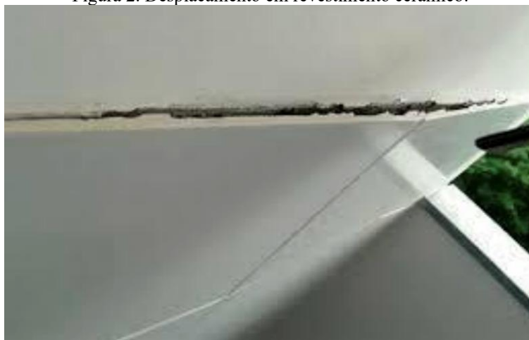
Figura 2. Deslocamento em revestimento cerâmico.
