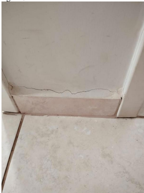
Figura 5. Saliência em revestimento cerâmico.
