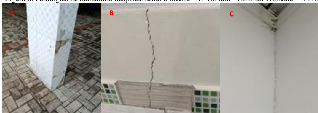
Figura 6. Patologias de rachadura, deslocamento e fissura – IF Goiano - Campus Trindade – 2023.
