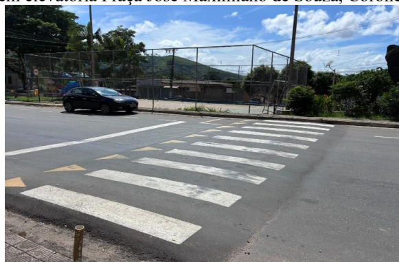
Figura 8 – Passagem elevatória Praça José Maximiano de Souza, Coronel Fabriciano (MG).
