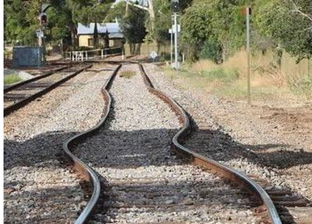
Figura 1 : Dilatação Superficial nos trilhos
