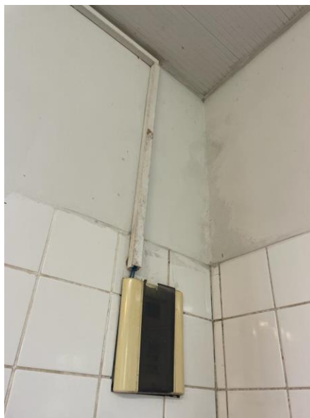
Figura 17 - Trechos das instalações elétricas estão desprotegidos em tubulações externas.
