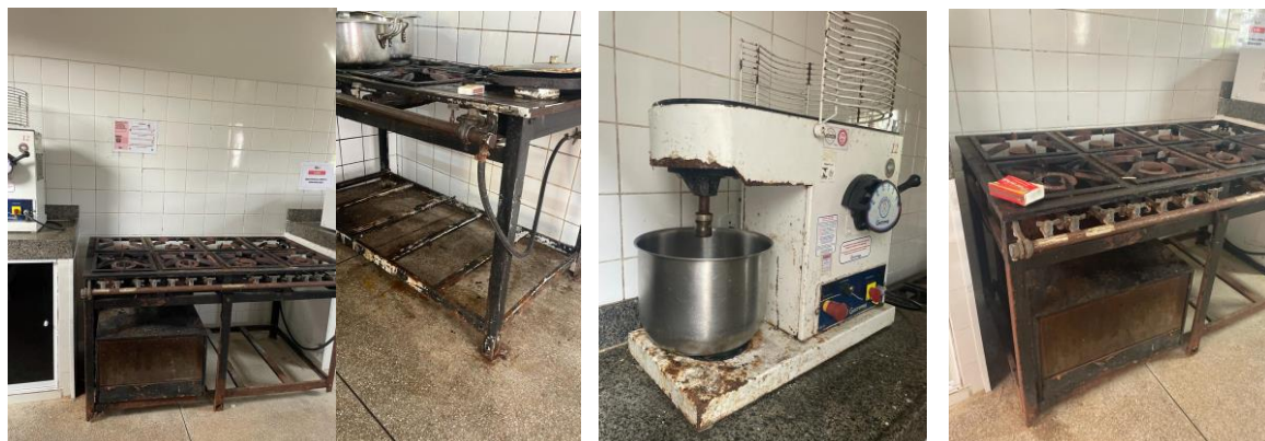
Figura 18 - Equipamentos estão com muito ferrugem.
