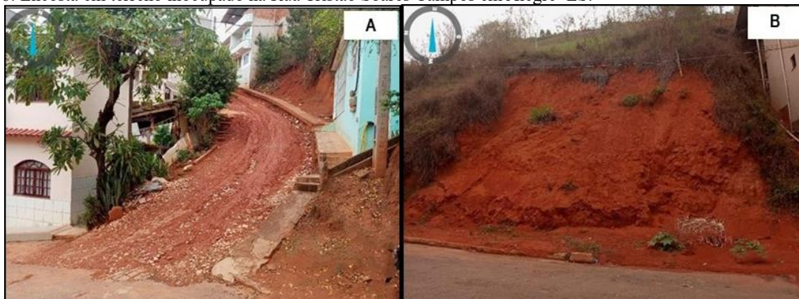
Figura 17 - A) Ponto 4: Estrada de terra em declive próximo a drenagem na Rua dos Espanhóis, Colina, Alegre-ES; B) Ponto 6: Encosta em terreno inocupado na Rua Tristão Soares Campos em Alegre-ES.
