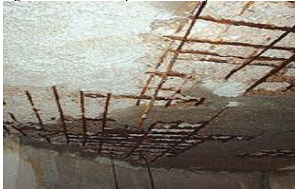
Figura 5 - Armadura aparente com a perda de sólidos.
