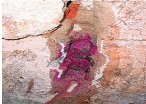
Figura 4 - Peça em concreto com grande perda de massa pelo transporte de material solúvel.
