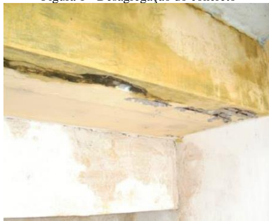
Figura 1 - Desagregação do concreto
